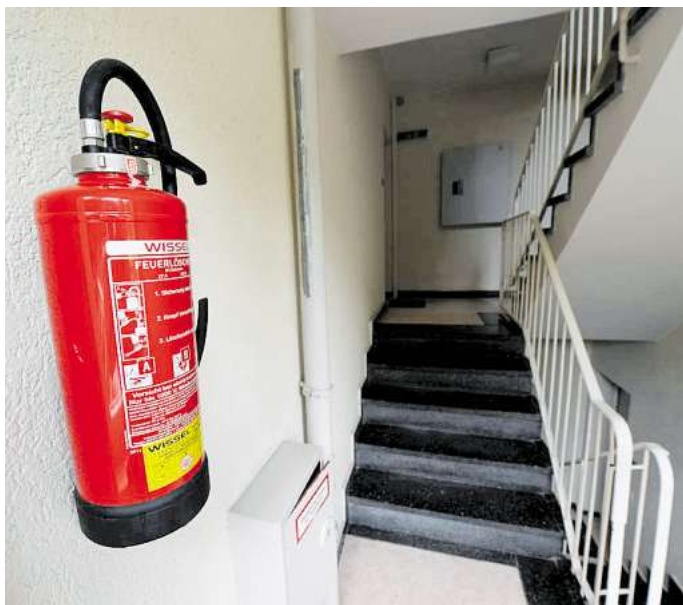
Feuerlöscher gibt es mit den Löschmitteln Pulver, Wasser, Schaum oder Kohlendioxid. Foto: Arne Dedert
