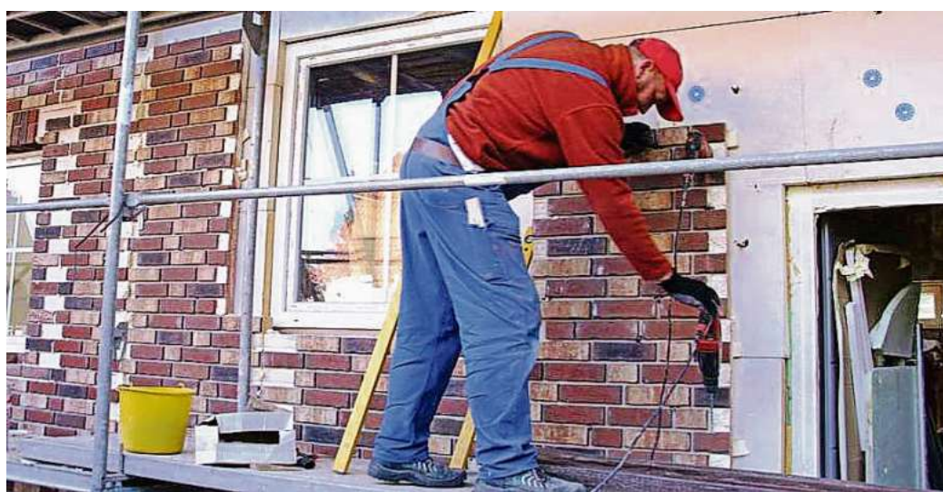
Wer die Fassade seines Hauses saniert, schützt die Bausubstanz und verbessert die Energieeffizienz. Foto: djd/Böger
